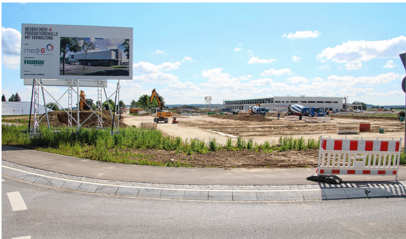
Mit den Arbeiten für den Neubau des Leibertinger Medizintechnik-Unternehmens Medi-G im Meßkircher Industriepark Nördlicher Bodensee wurde jetzt begonnen. Im Hintergrund (rechts) ist die Baustelle des Verteilzentrums des Onlineversandhändlers Amazon zu erkennen, die im Herbst fertig sein soll. BILD: MANFRED DIETERLE-JÖCHLE
